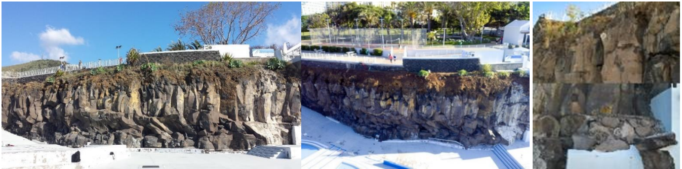
Figura 1 – Talude Rochoso no Complexo Balnear do Lido (Esquerda – aquando da campanha de teste; Centro – após limpeza; Direita – identificação de alvos topográficos pintados no talude rochoso)
